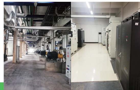
变频器在纸厂水泵上的应用
